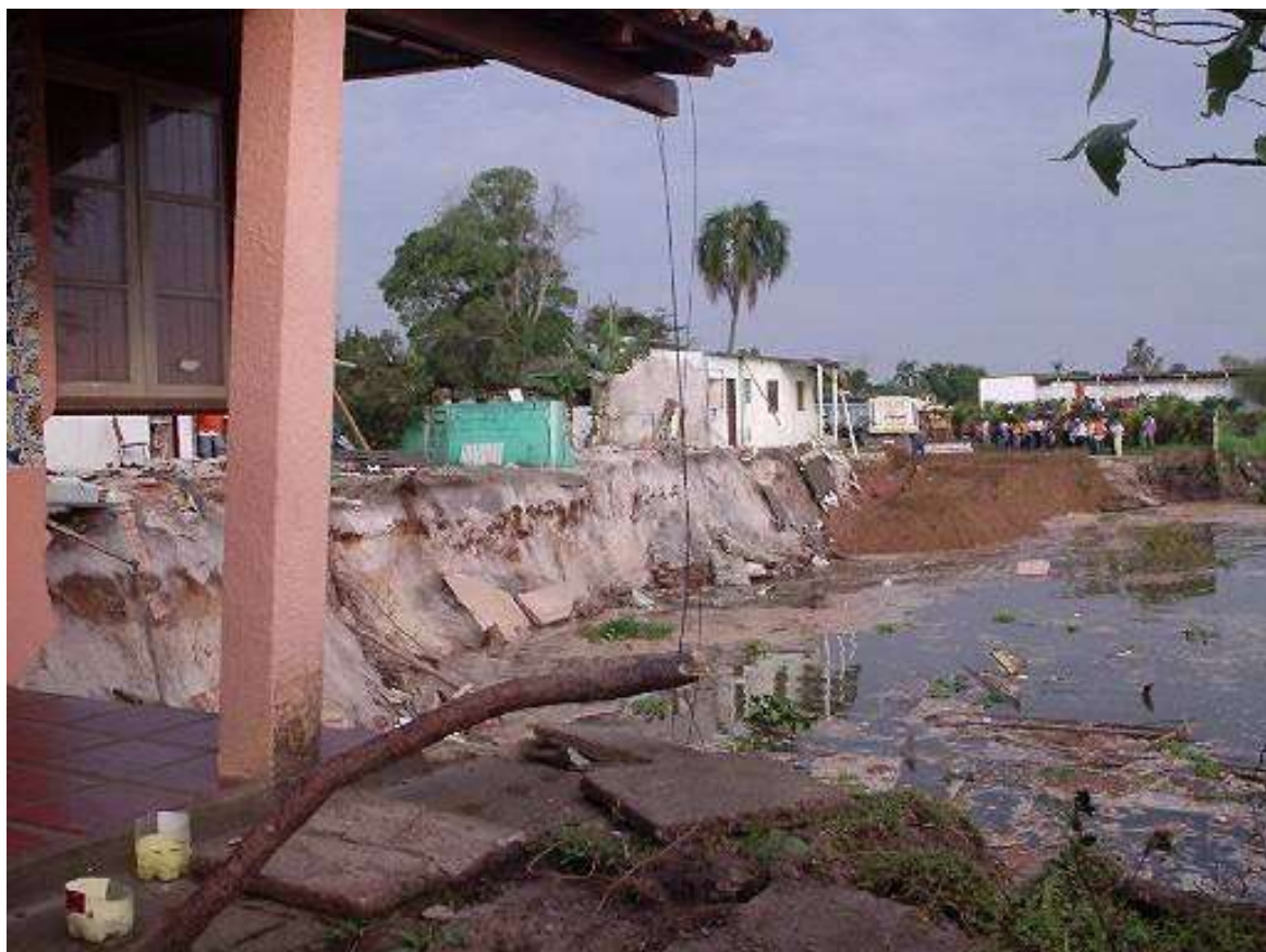
Figura 5.5 – Desmoronamento da margem esquerda do Canal do Valo Grande em 2006. Autor: Marcelo Pessanha
