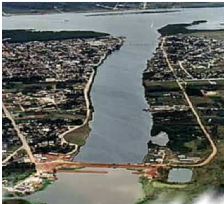
Figura 5.3 – Início da construção do Vertedouro. Nota-se no detalhe a construção da ensecadeira à montante.
